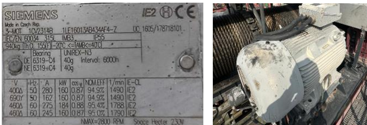
Gambar 2. (a) Nameplate pada Motor Hoist 160Kw (b) Bentuk Fisik Motor Hoist
